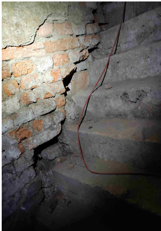
↑ Foto č. 8: Vlhkostí degradované cihly kolem schůďů v 1.PP, kde se však většinou vyskytuje zdivo kamenné.
