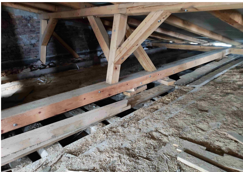
⇐ Foto č. 13: Podivné (nesystémové) podepření vazného trámu krovu na stropnicích. Tímto však dochází ke značnému přetížení dotčených stropnic.
