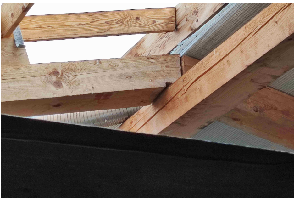
⇐ Foto č. 15: Kromě ne zcela přesného a odborného tesařského provedení krovu je patrná degradace podstřešní fólie vlivem UV záření.
